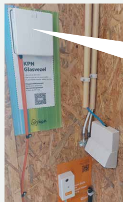
Glasvezel-aansluiting in de meterkast
